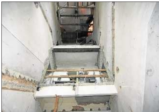
Noch kann man vom Erdgeschoss den Dachstuhl sehen, da auch das gesamte Treppenhaus erneuert werden muss. RN-Foto
